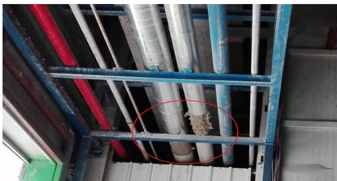
Fig. 7 Imperfection de la protection de l'isolation
